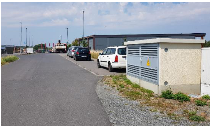
Abbildung 29: Trafostation im Gewerbegebiet Rennenberg
